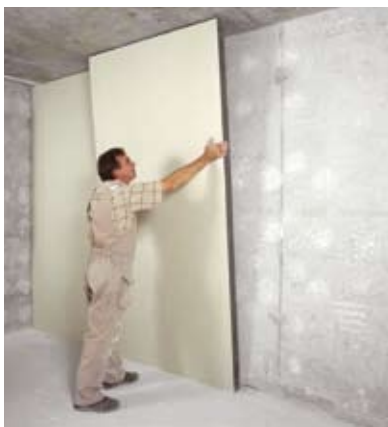
Pose d'un doublage isolant ; les isolants sont en laine minérale, PSE, PSX, PUR.
